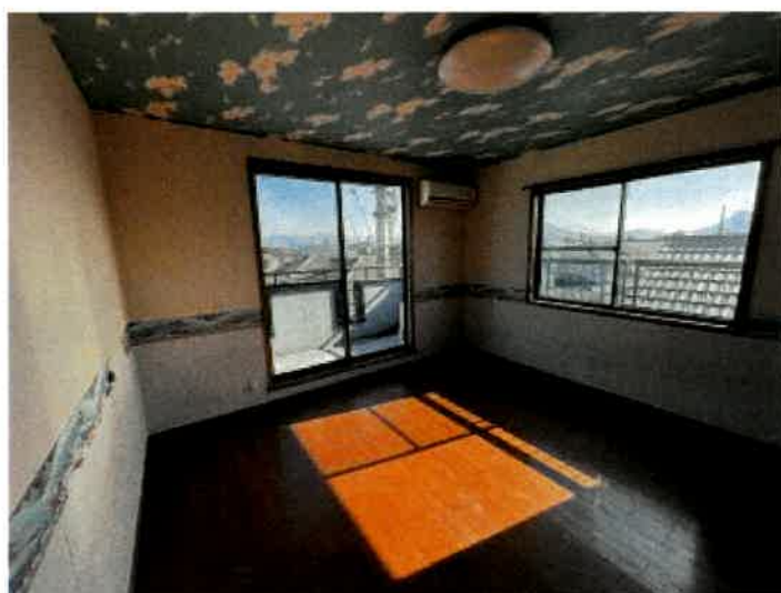
物件3 3階南側洋室の状況
