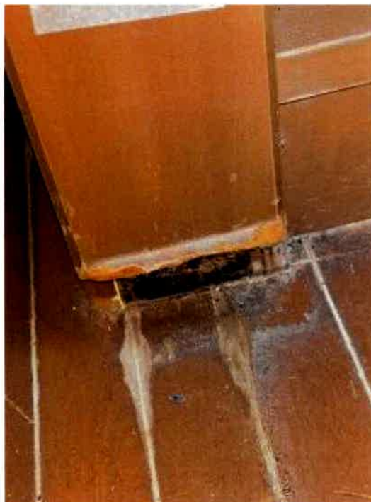
物件3 1階階段下の損傷状況
