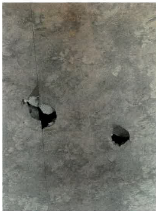
物件3 1階南側洋室壁の損傷状況
