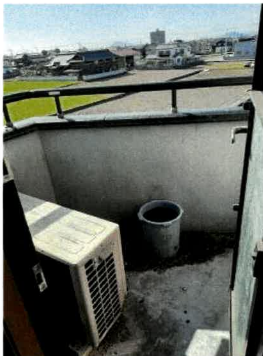
物件3 3階北西側バルコニーの状況
