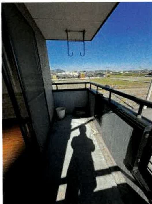
物件3 2階バルコニーの状況
