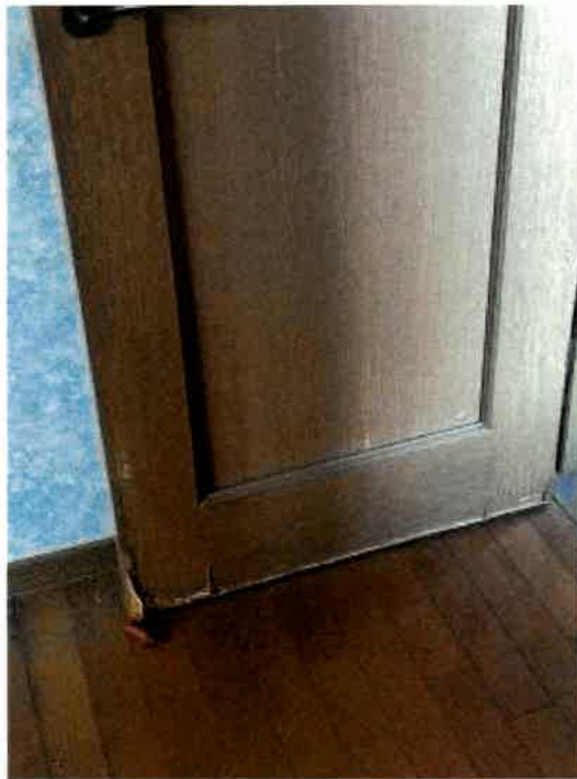
物件3 1階南側洋ドアの損傷状況
