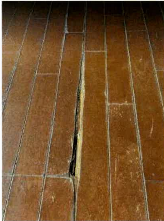
物件3 2階LD床の損傷状況
