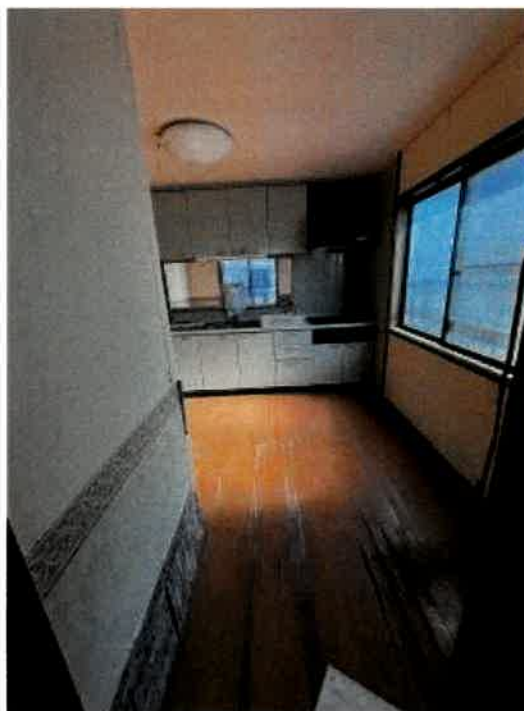
物件3 2階台所床の損傷状況
