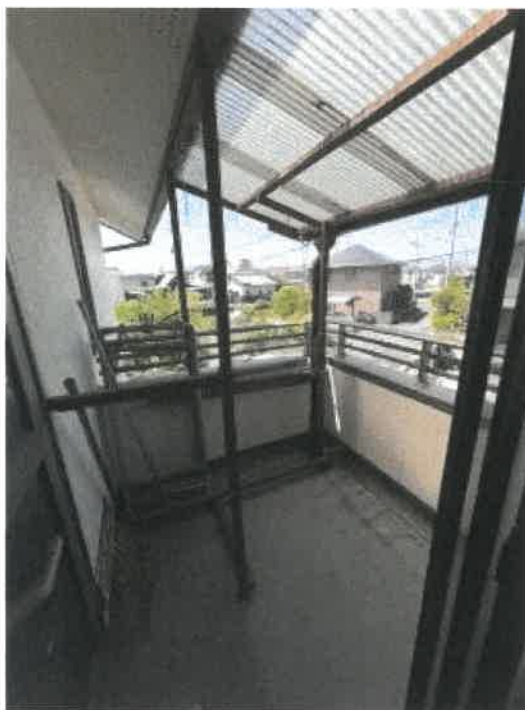
物件3 2階ベランダの状況
