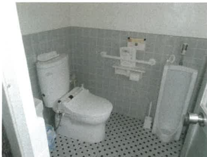
物件5主である建物のトイレの状況
