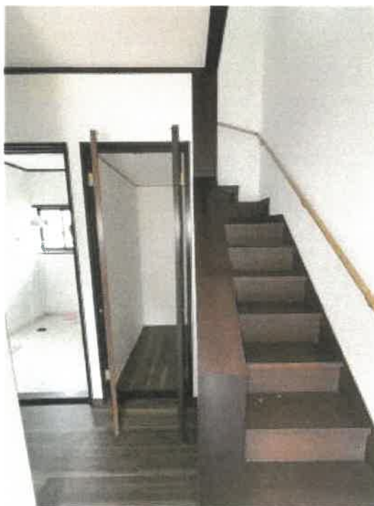
物件2 階段の状況
