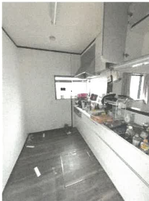
物件2 1階台所の状況
