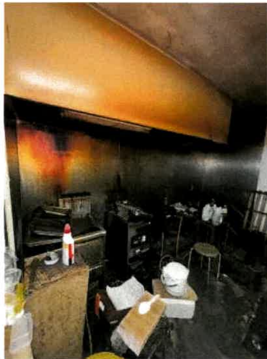
物件4 調理場東側奥の厨房（未登記増築部分）の状況
