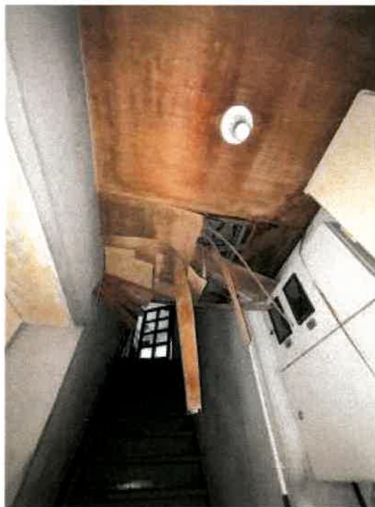
物件 4 居宅への階段上部の状況
