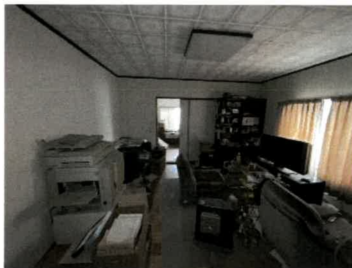
物件 4 2階中央台所西横の洋室の状況
