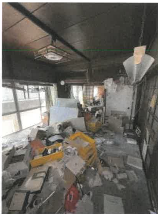
物件6 居宅部分1階東側和室の状況
