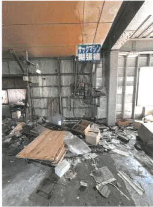
物件 6 1階工場内事務室横電気設備の状況
