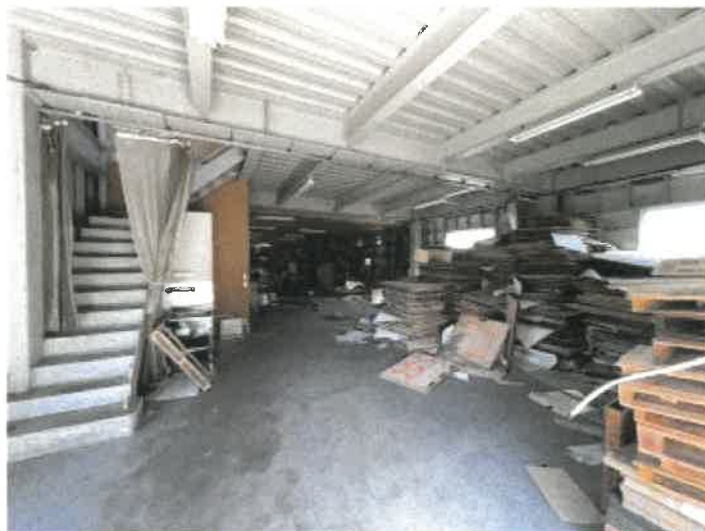
物件6 1階工場西側の状況
