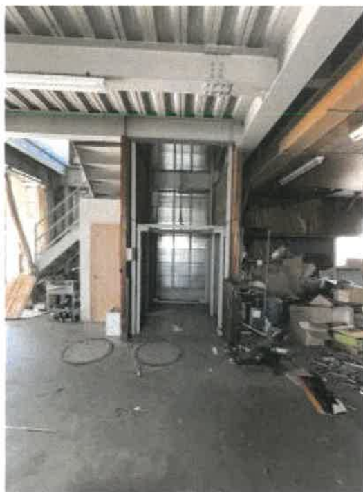
物件6 1階荷物運搬用リフトの状況
