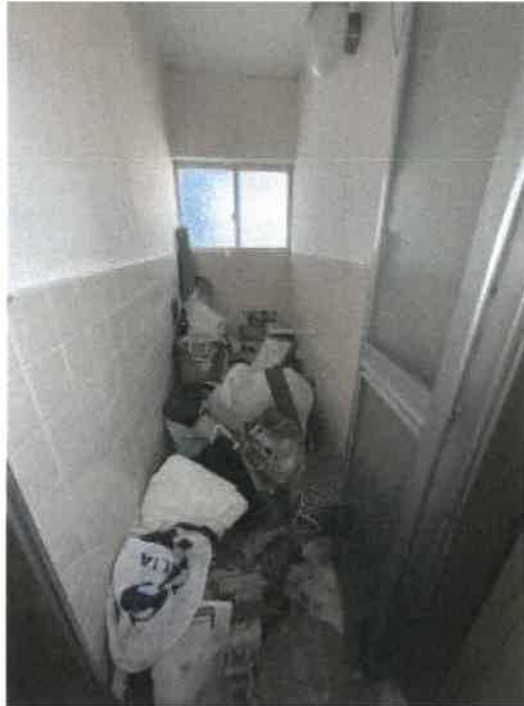
物件6 居宅部分1階物入（浴室跡）の状況
