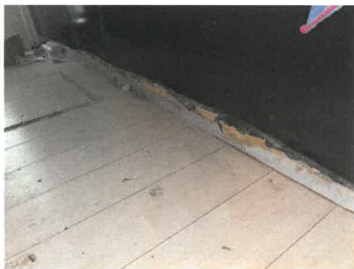
物件 2 1 階台所流し扉下部の状況
