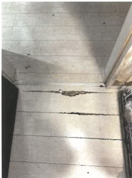
物件2 1階LDK北西側床の状況
