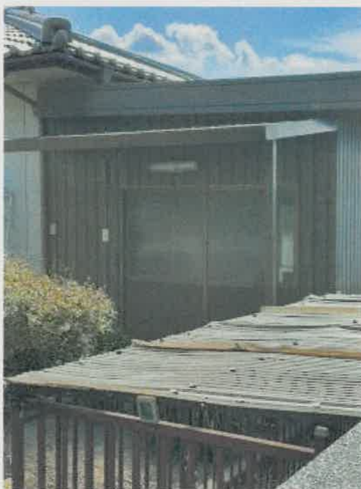
未登記増築部分（倉庫）の状況
