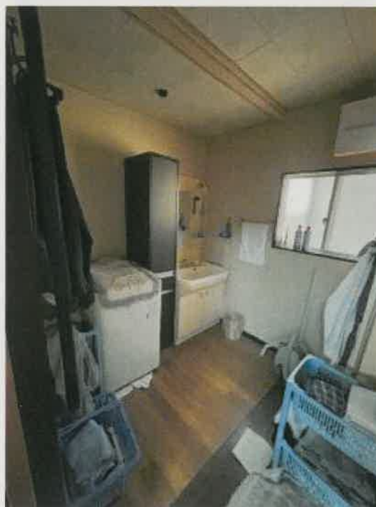
2階建部分1階洗面所・脱衣所の状況
