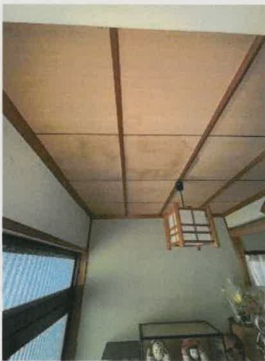
平家建部分玄関天井の雨漏跡の状況
