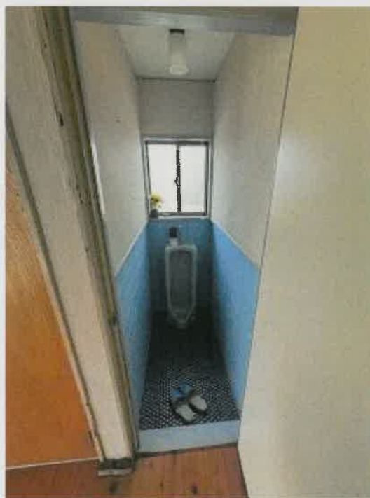
トイレ（小）の状況
