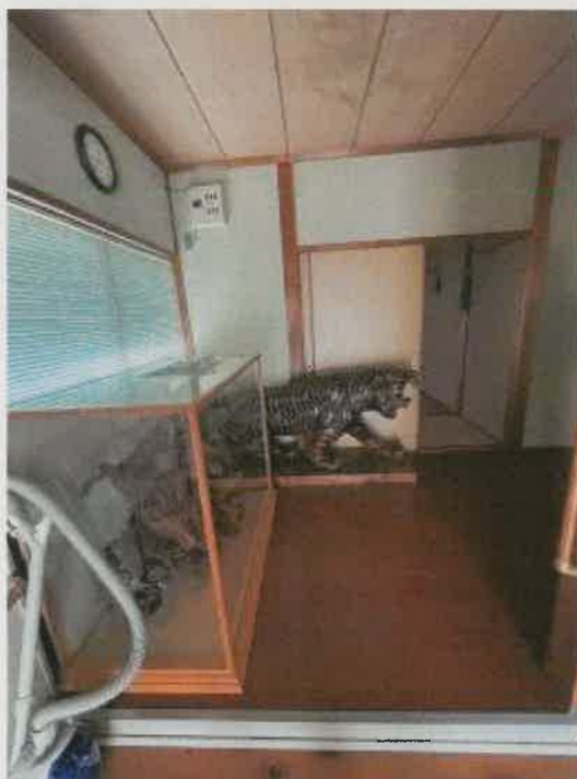
平家建部分ホール北西側天井の雨漏跡の状況
