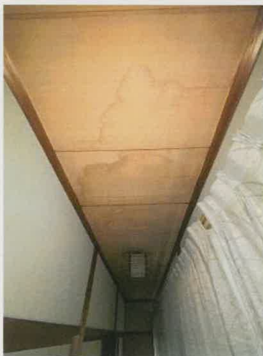
平家建部分縁側天井の雨漏り跡の状況
