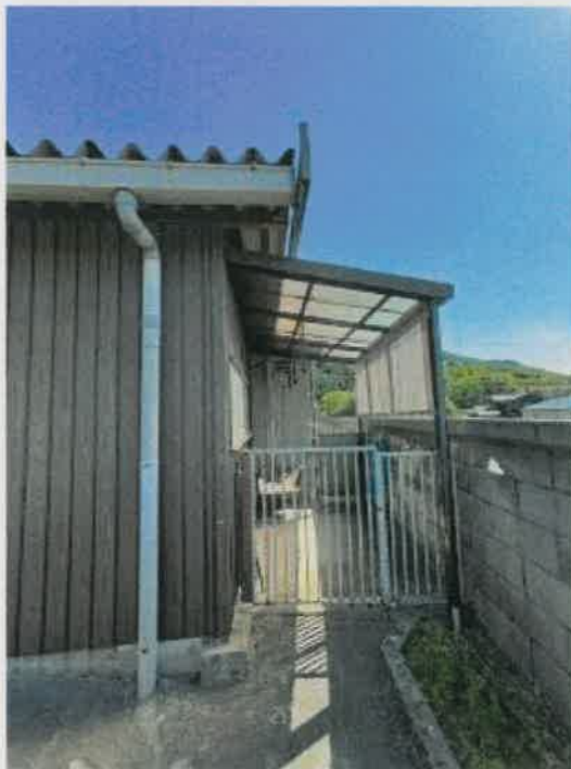
未登記増築部分（倉庫）北西側の状況
