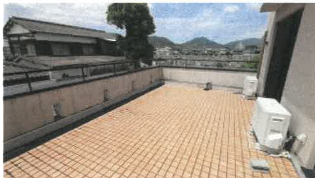
物件 2 2階南側ベランダの状況
