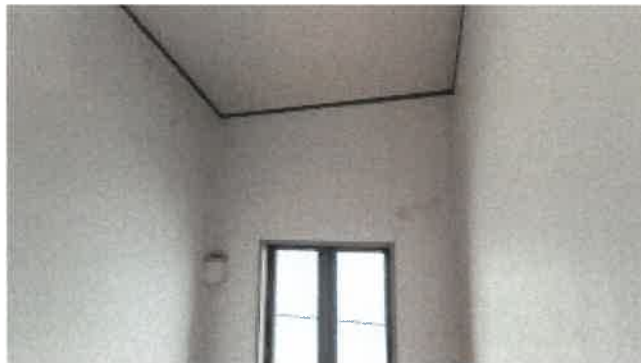
物件 2 2階階段付近の上部壁面の状況
