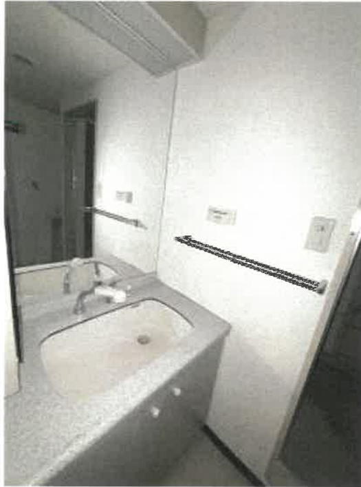
洗面所の状況
