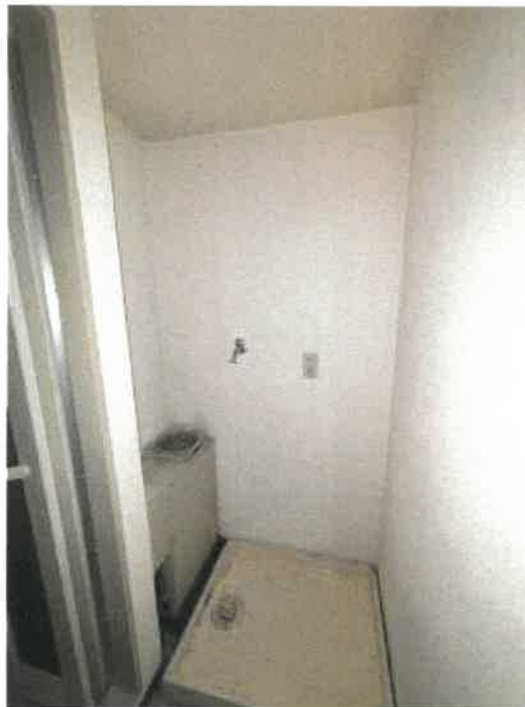
洗濯パンの状況
