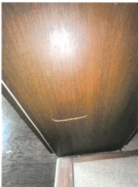
台所両面ハッチの損傷状況
