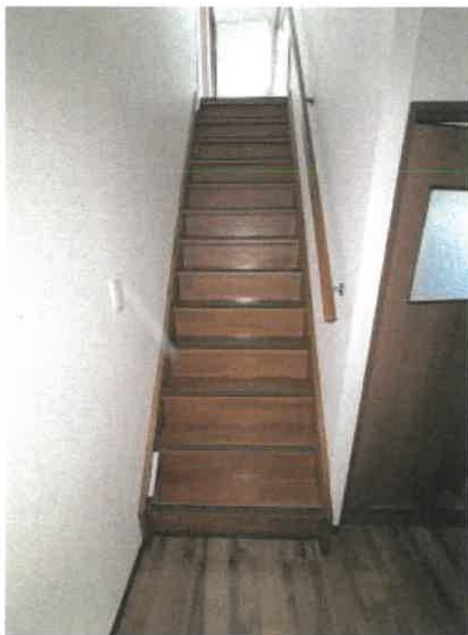
物件3 階段の状況
