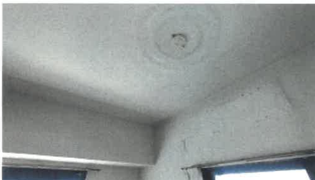
リビング・ダイニング天井のクラック（ひび割れ）の状況
