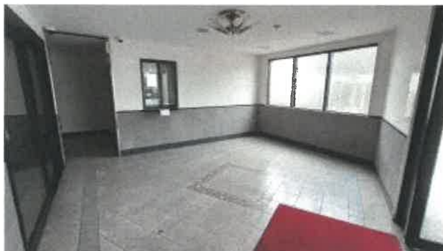
本件マンションエントランス内の状況
