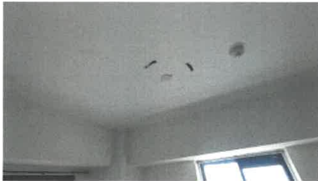
東側洋室天井のクラック（ひび割れ）の状況
