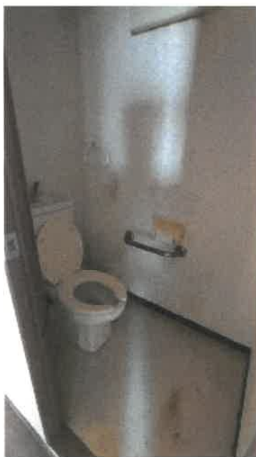
トイレの状況
