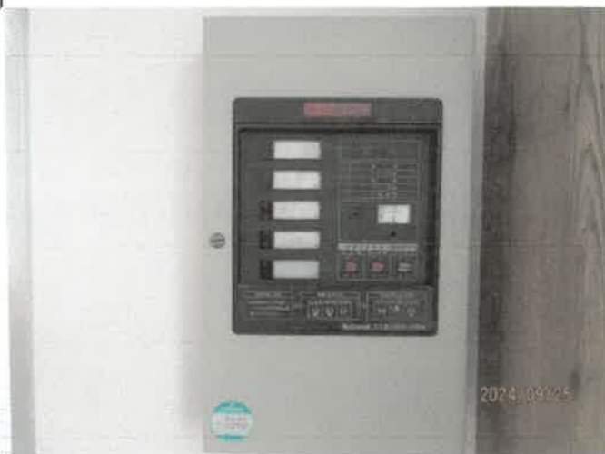
給湯室 (火災報知器)
