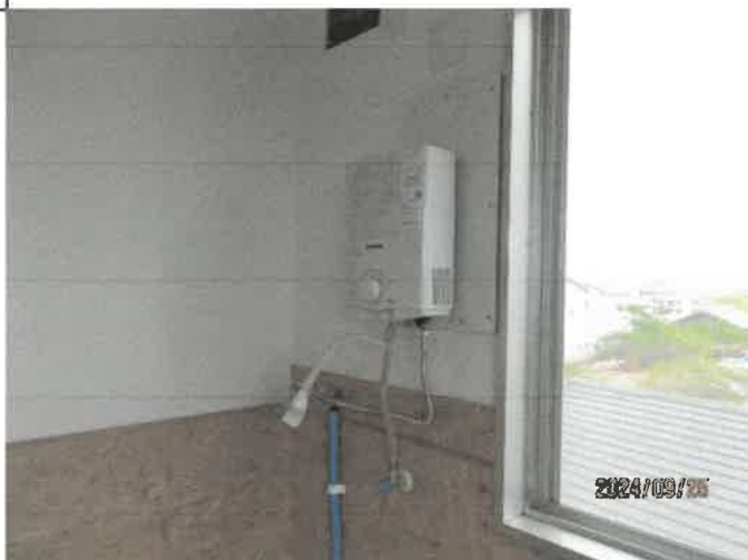
給湯室 (台所用ガス湯沸かし器)
