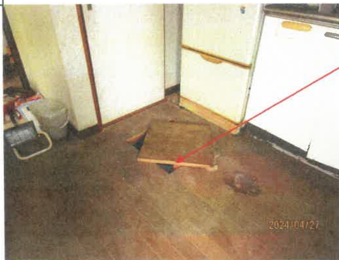
台所床の破損
