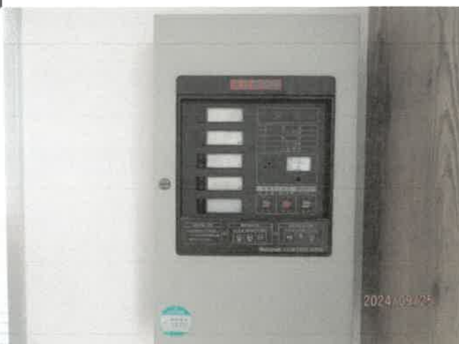
給湯室 (火災報知器)
