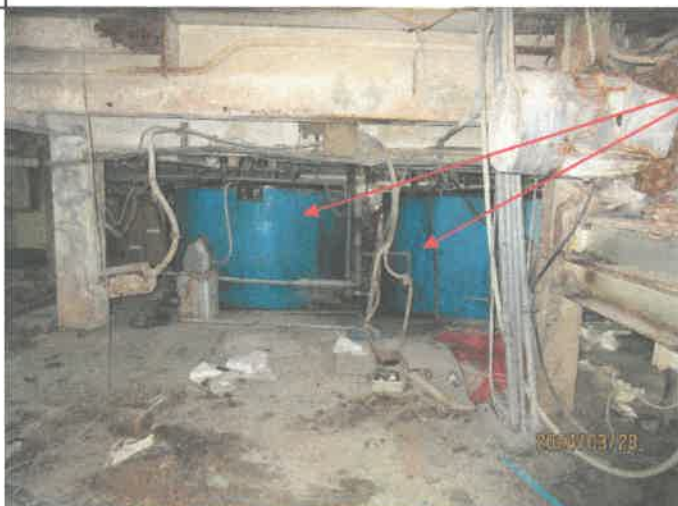
物件3 3階 割水タンク
