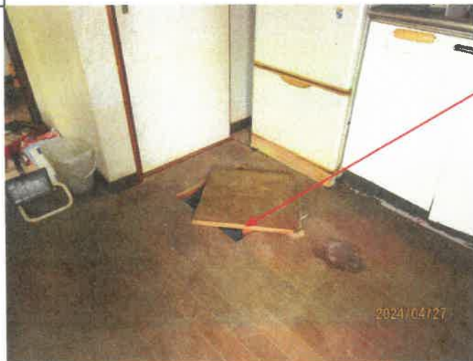
台所床の破損
