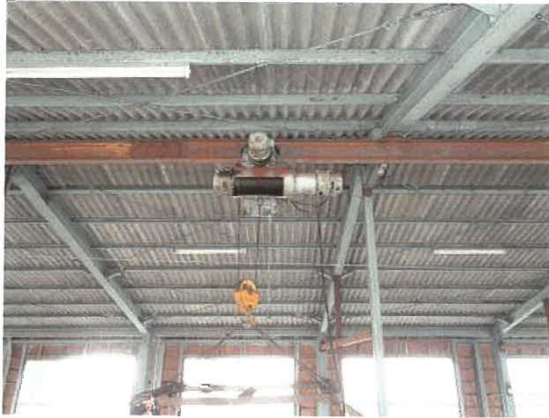
物件 1 7 倉庫⑦天井設置の移動式クレーン
