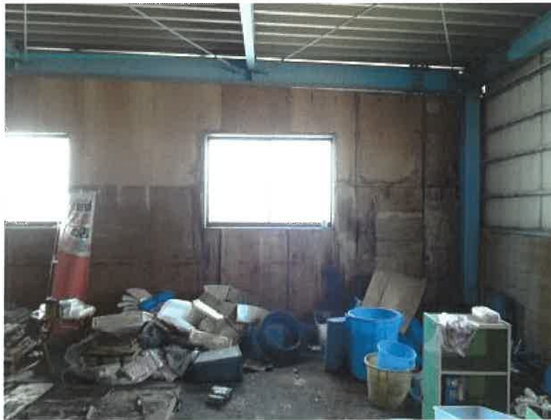
1階車庫（雨漏りがうかがわれる部分）
