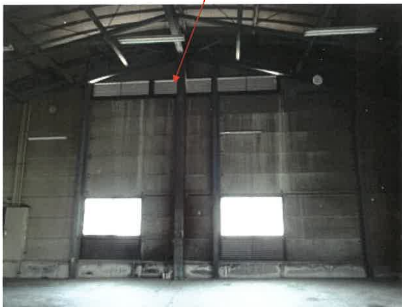
車庫（雨水の浸入がうかがわれる部分）
