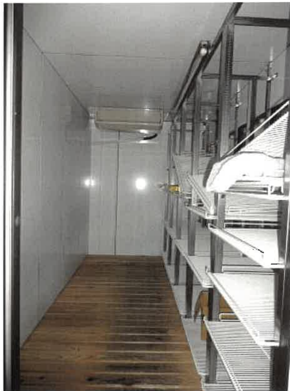
1 階店舗内冷蔵庫
