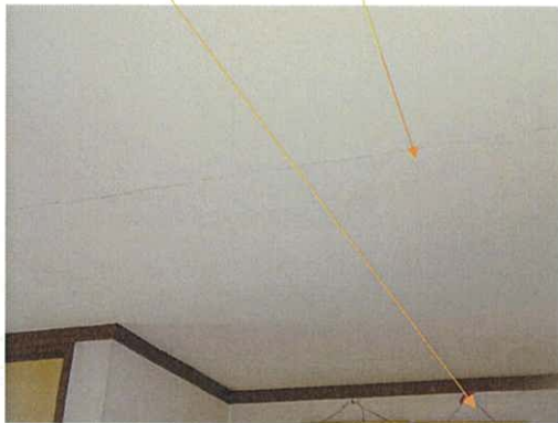
⑬ 壁クロス剥離, 天井クロス損傷
