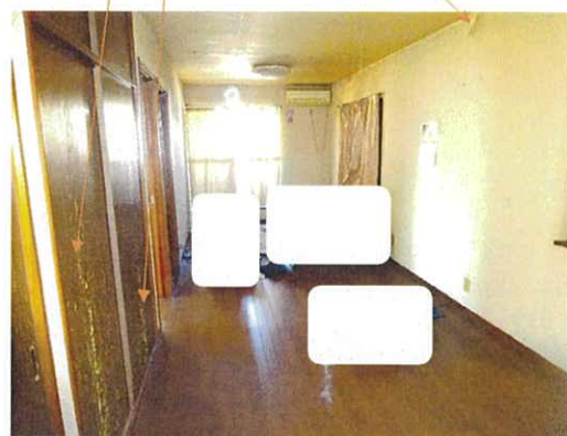
⑭ 2階 建具損傷 壁クロス剥離
