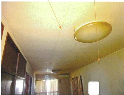
⑮ 天井クロス損傷 壁クロス剥離
