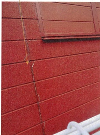
⑤ 外壁クラック
