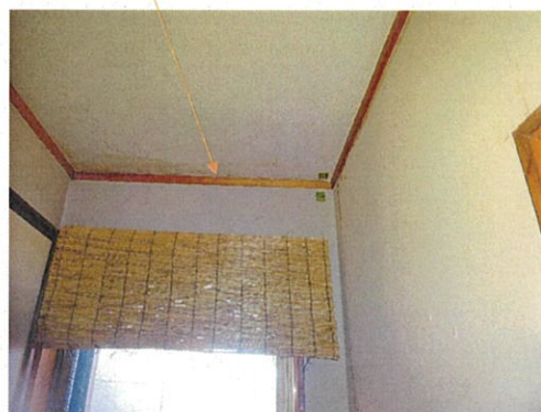
②4 雨漏り跡
