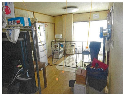
⑭ 1階居宅 床劣化 犬飼育部分
