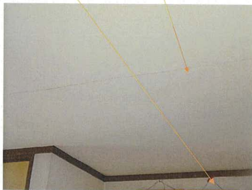
⑬ 壁クロス剥離, 天井クロス損傷
