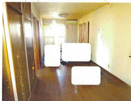
⑭ 2階 建具損傷 壁クロス剥離
