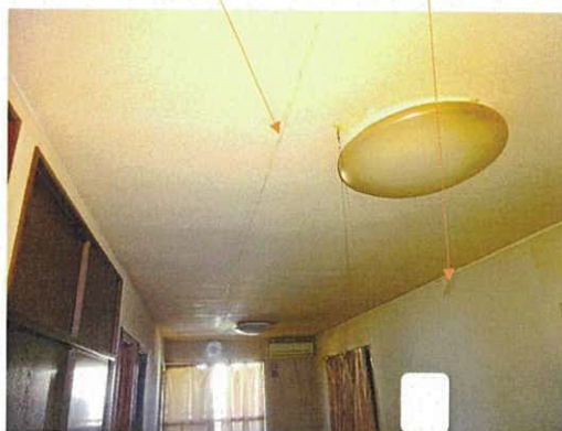
⑮ 天井クロス損傷 壁クロス剥離
