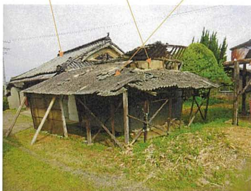
⑤ 物件4主たる建物 物件4附属建物2の残骸，差し掛け等
