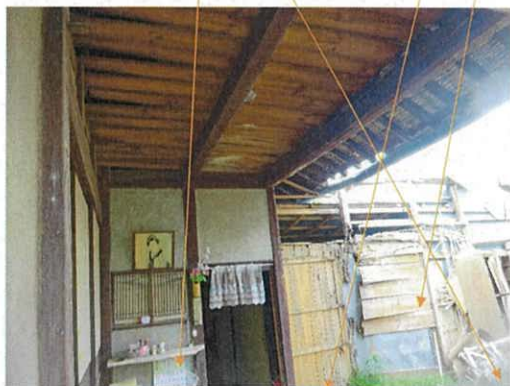
⑬ 物件4主たる建物内部 周壁崩壊部分 物件4附属建物符号2崩壊部分，残骸
