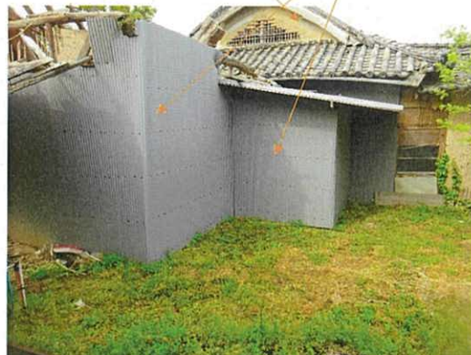
⑥ 物件4主たる建物 物件4附属建物2の残骸にトタンで囲んだ部分
