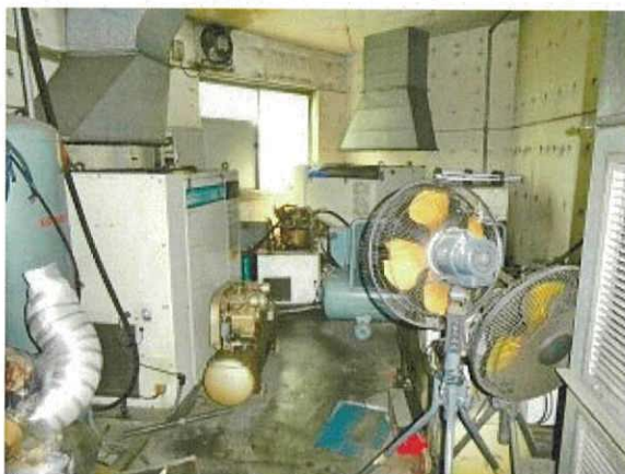
機械室の状況
