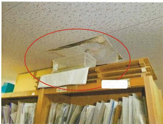
倉庫の天井・雨漏り痕の状況
