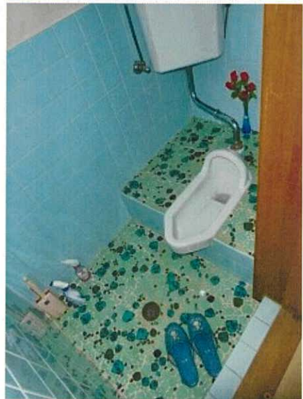
未登記増築部分の状況
