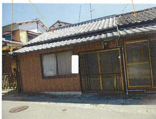
② 物件2 家屋番号伊吹町甲14番1の1の建物 屋根損傷
