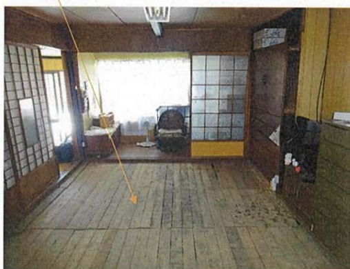
⑤ 物件2内部 畳床劣化
