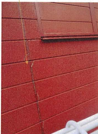
⑤ 外壁クラック
