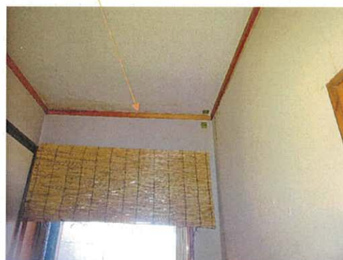
②⑭ 雨漏り跡
