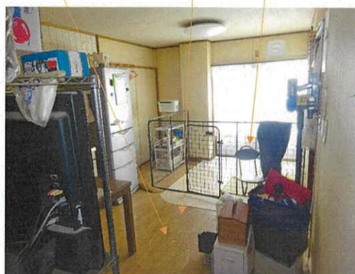
⑭ 1階居宅 床劣化 犬飼育部分
