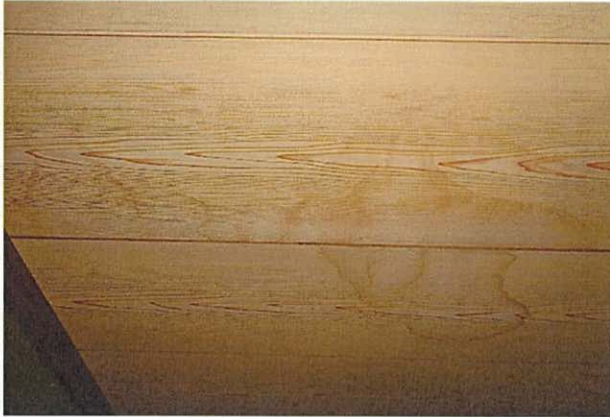
25 (雨漏り痕の状況)
