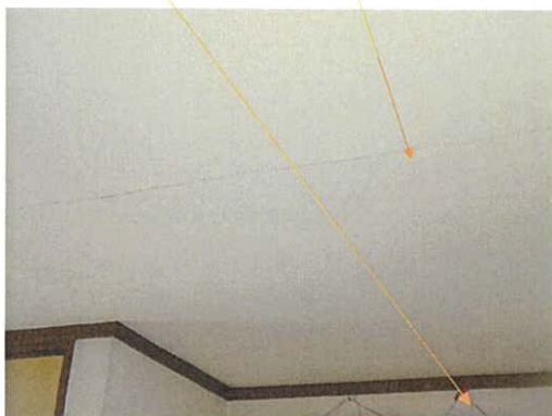
⑬ 壁クロス剥離, 天井クロス損傷
