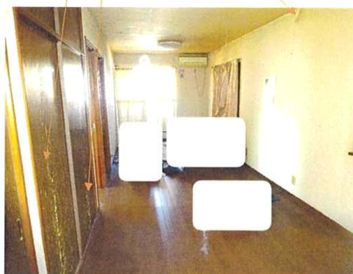
⑭ 2階 建具損傷 壁クロス剥離
