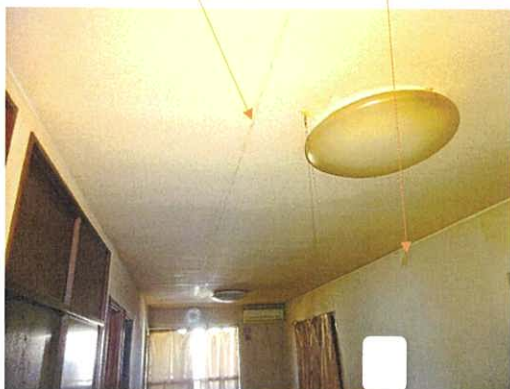
⑮ 天井クロス損傷 壁クロス剥離
