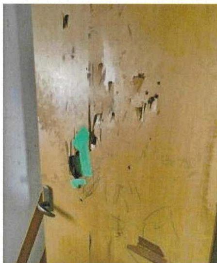
ドアの損傷状況
