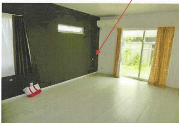
クロスの一部剥離
