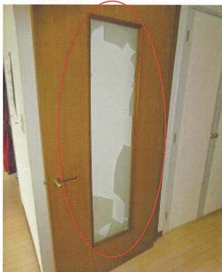
ドアのガラスが割れた状況
