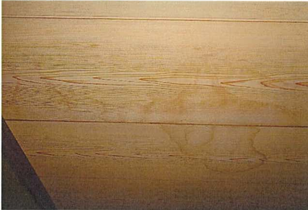
25 (雨漏り痕の状況)
