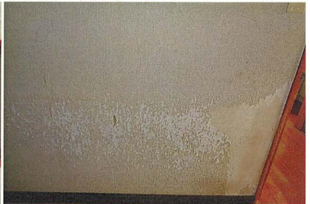
28 (内壁クロス剥がれの状況)
