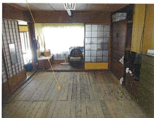
⑤ 物件 2 内部 畳床劣化
