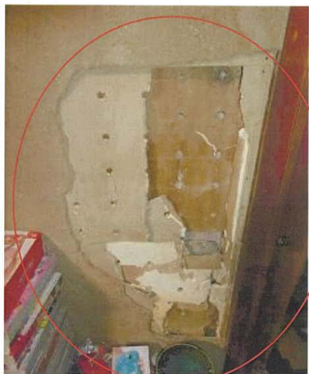
内壁の損傷状況
