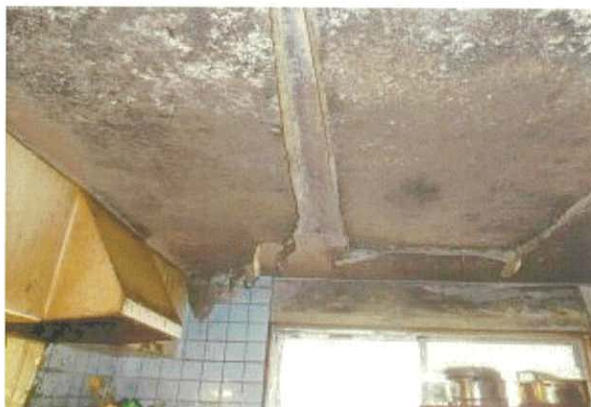
焼損痕の状況
