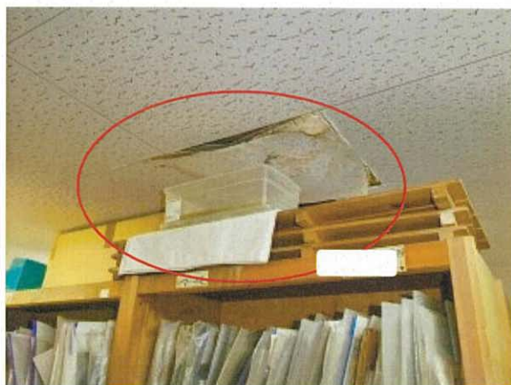
倉庫の天井・雨漏り痕の状況
