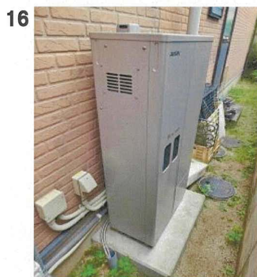
燃料電池ユニットの状況
