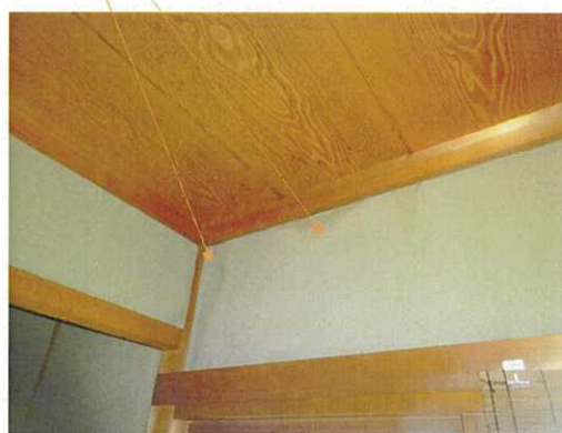
⑤ 雨漏り跡
