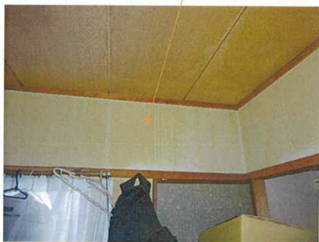
④ 407号室 雨漏り跡
