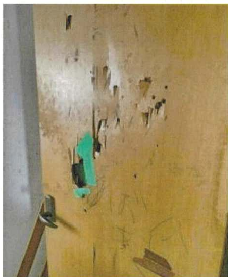
ドアの損傷状況
