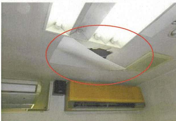
雨漏り痕の状況
