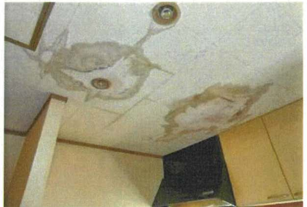
雨漏り跡の状況
