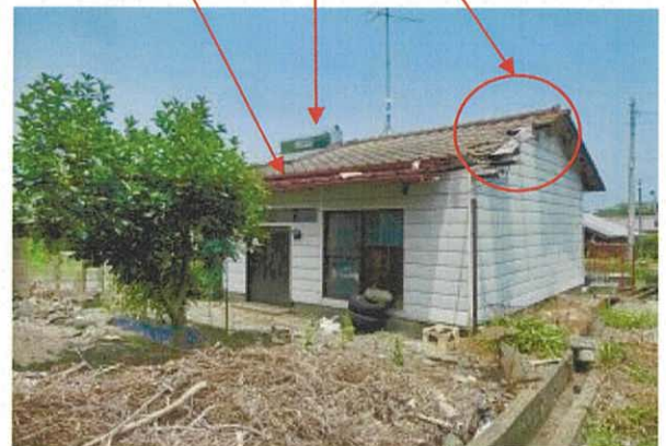
使用されていない太陽熱温水器 屋根の損傷
