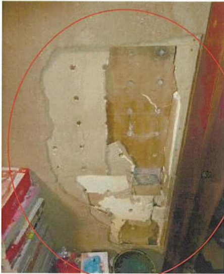
内壁の損傷状況
