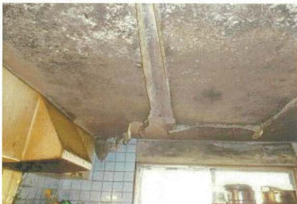
焼損痕の状況
