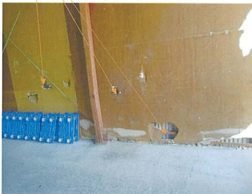
⑦ 内壁損傷箇所
