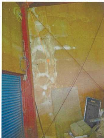
⑨ 雨漏り跡
