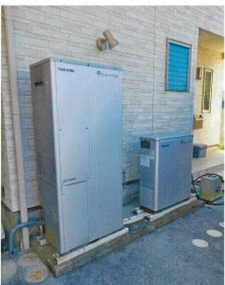
「エネファーム」のシステム関係機器の状況
