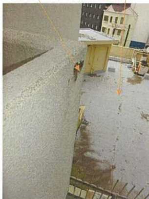
⑤⑤ 損傷 隣地上の建物
