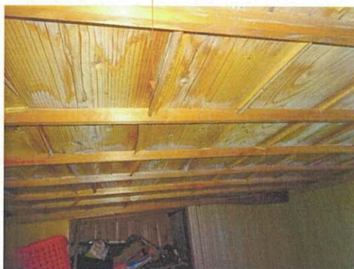
41 母屋2階 雨漏り跡
