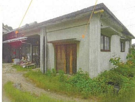
物件 4 主たる建物 未登記増築部分
