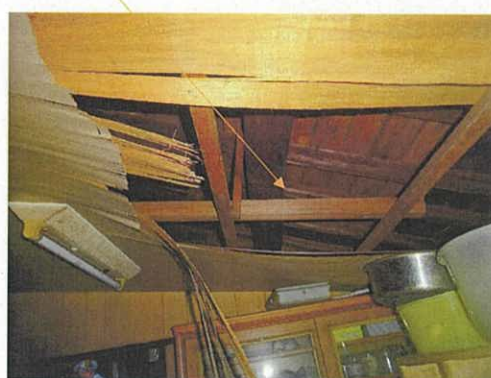
③⑥ 天井損傷
