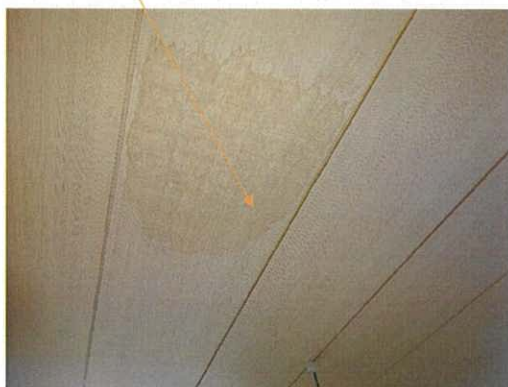
⑮ 雨漏り跡
