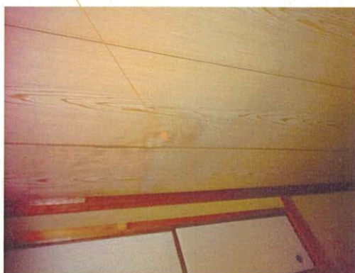
⑤ 雨漏り跡
