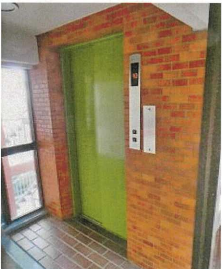
エレベーターの状況
